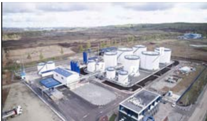
1 – резервуары длительного хранения; 2 – резервуары интенсивного нагрева; 3 – эстакада трубопроводов.
